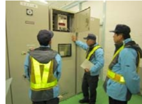
社長巡回(奥田変電所)
